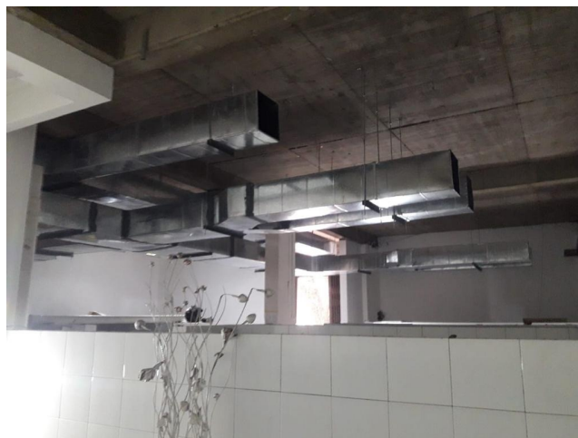
Dokumentasi instalasi dapur dari arsip Gastro. Akses teknis perlu diperiksa sebelum investasi ruang. Foto: arsip Gastro F&B.
